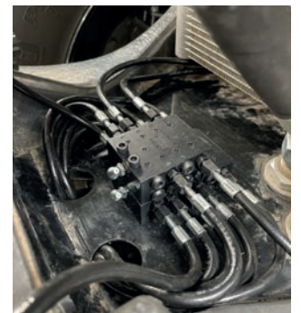
S-sarjan keskitetty etuakselin ja etunostolaitteen voitelujärjestelmä.
